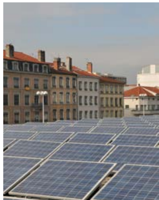
Panneaux Photovoltaïques, Lyon 3
